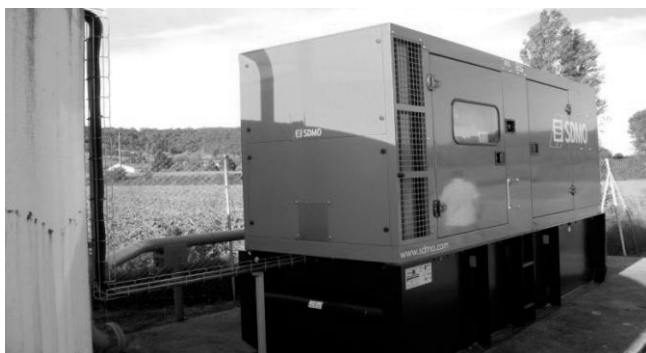
Groupes électrogènes sur le forage de camp de garde à Tournon
