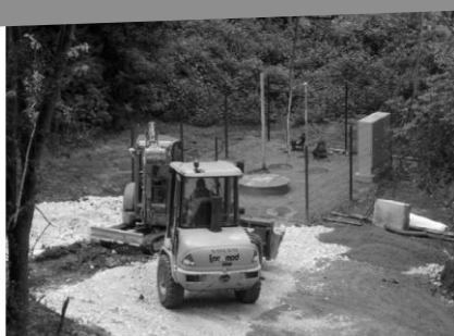
Poste de refoulement Saint Germain à Laroque Timbaut
